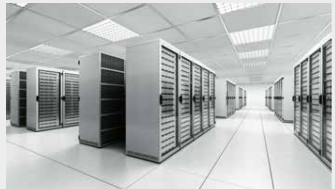
In Serverräumen laufen riesige Datenmengen zusammen. Foto: stock.adobe.com / zentilia
